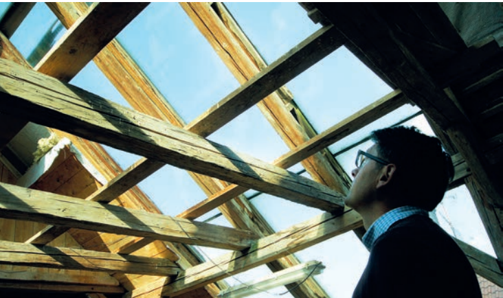
"Je to zajímavý nápad, ale musí být funkční. Tady ale skrz střechu léta zatéká a kostel to devastuje", vysvětluje Vít Pivoňka.
