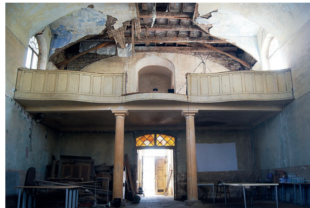
Stav kostela na první pohled není dobrý. Největším problémem je zde voda a vlhkost, proto jako první na řadu přijde rekonstrukce střechy.
