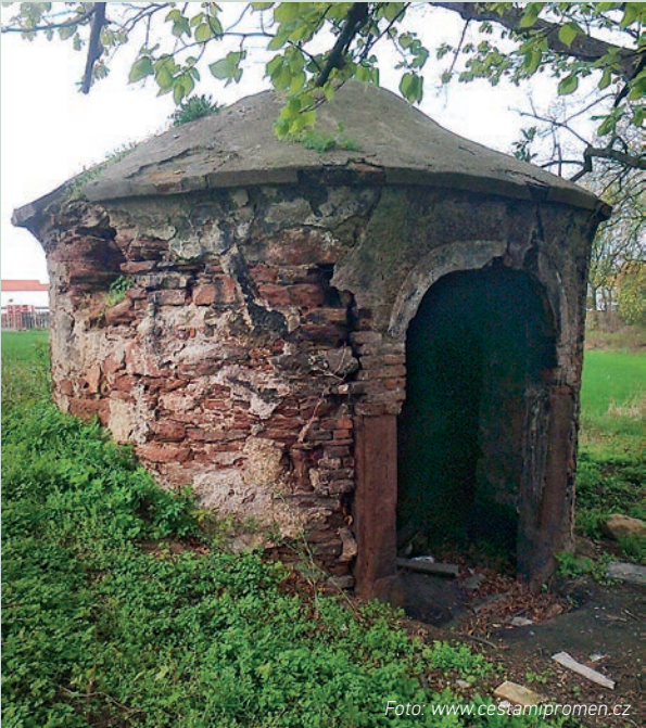
Barokní kaple sv. Gotharda v Českém Brodě chátrala, její obnova přišla v poslední chvíli. Zde stav před rekonstrukcí (2016)
